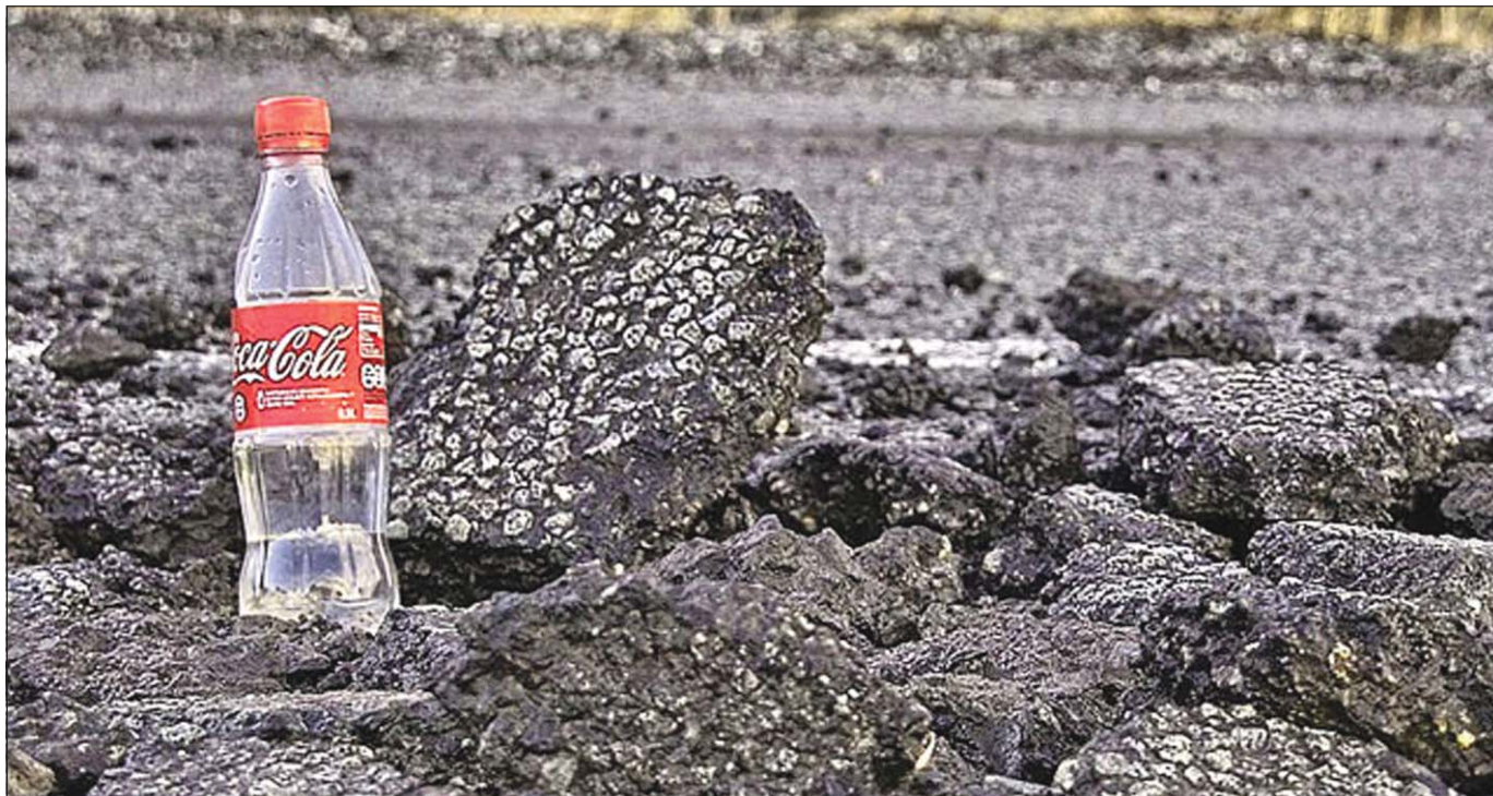
Vegurinn undir Súðavíkurhlíð er illa farinn. Mynd: Þórður Sigurðsson.
